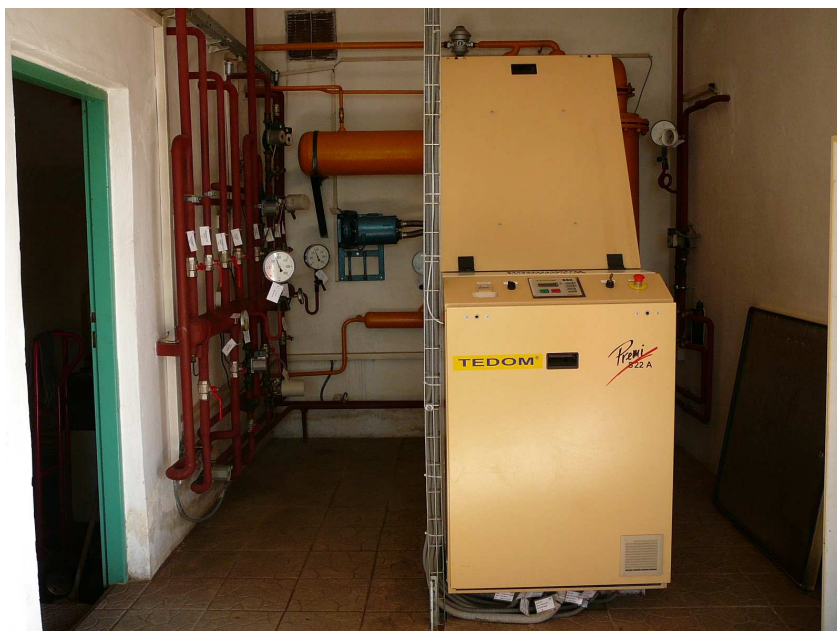
Obr 2 Kogeneračná jednotka o výkone 22 kW
